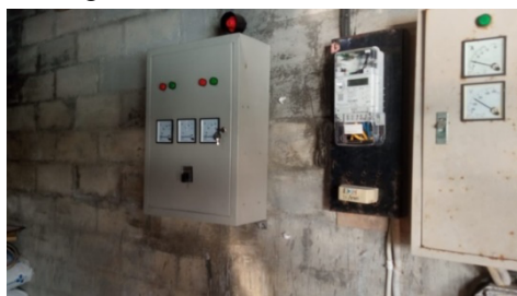
Gambar 13. Pemasangan alat di tambak udang kemiren
