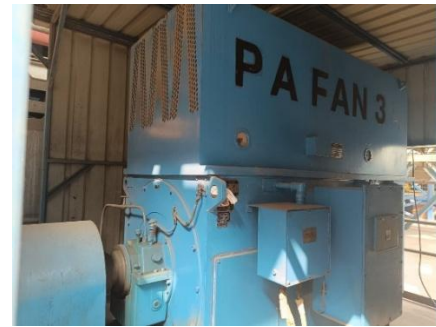
Gambar 1. Motor Primary Air Fan
